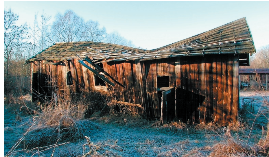
Förfallet av Brogård byggnader har redan gått så långt att vissa av dem inte går att rädda. Bilden föreställer ett uthus.
